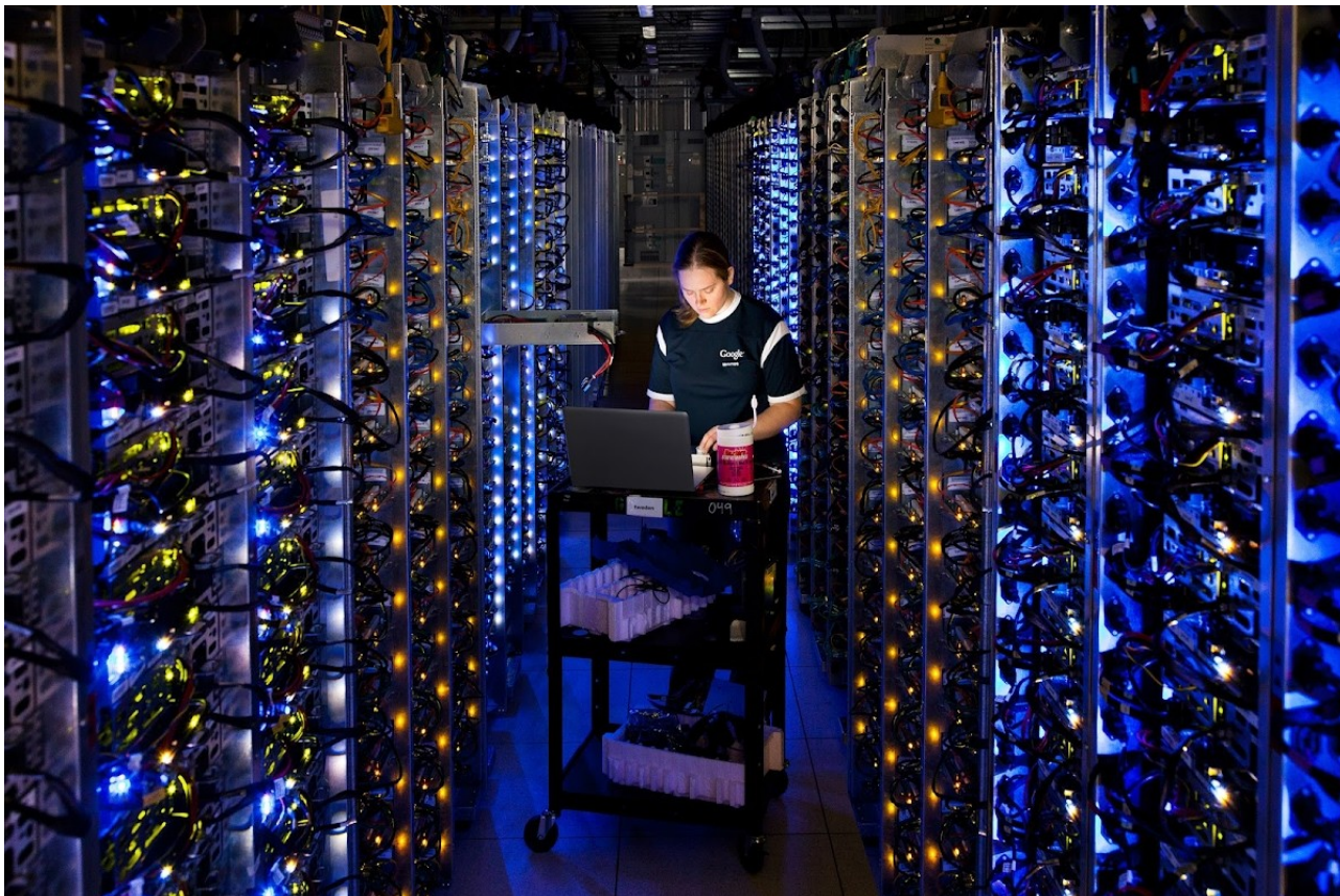
Imagem 3 – Trabalhadora do Google realiza diagnóstico de uma CPU superaquecida em um data center , The Dalles, Oregon.
